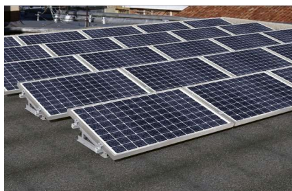
Vodorovná instalace solárních panelů
